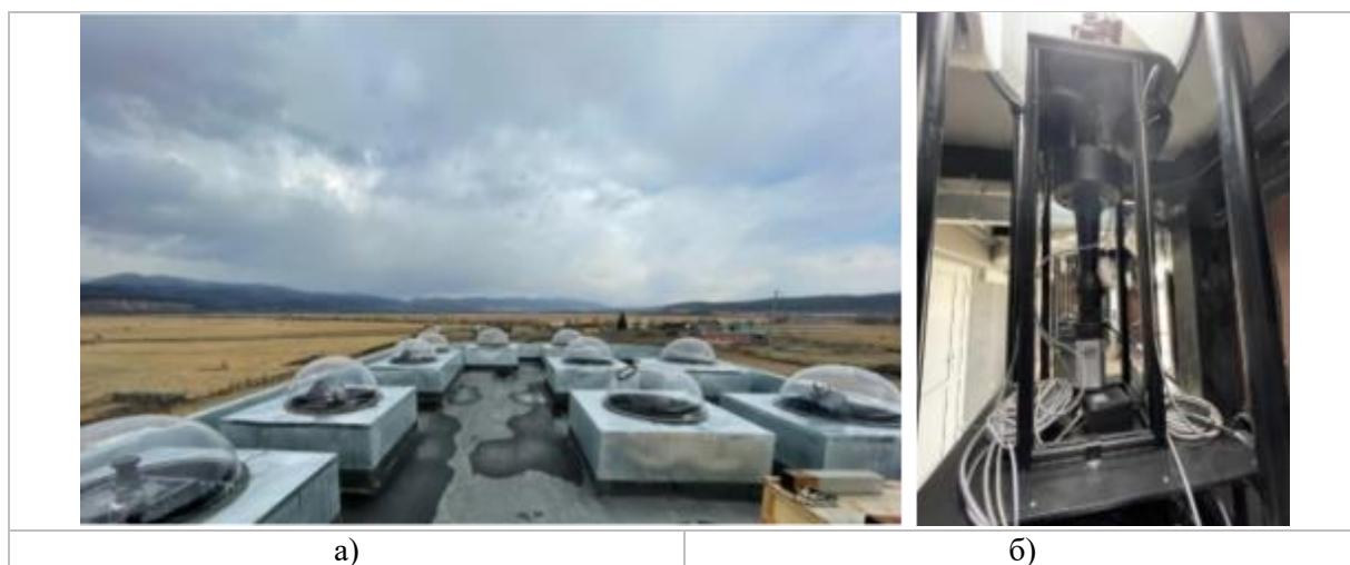
Рис. 1 а) - Общий вид крыши технического корпуса ГФО ИСЗФ СО РАН, б) - камера всего неба с подъемником
